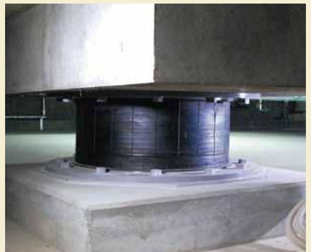
ブリヂストンの免震ゴムが地震の揺れを吸収
