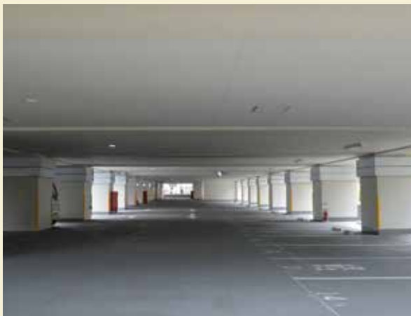
地上1階駐車場の中間層免震
