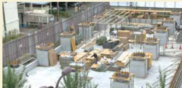
柱脚の上に取り付けられた免震装置
