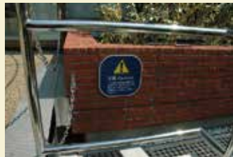
エキスパンションジョイント部分
