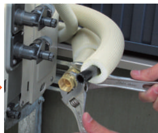
ホース・継手接続
