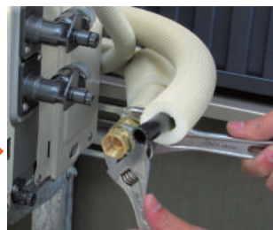
ホース・継手接続
