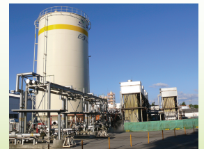
コ・ジェネレーションシステム
