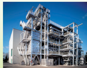
使用済みタイヤ焼却発電設備
