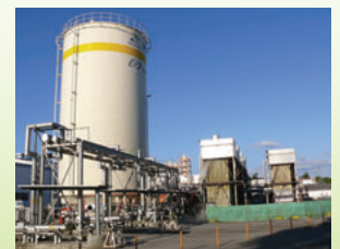
コ・ジェネレーションシステム
