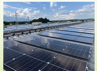
太陽光パネル
