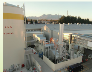
コ・ジェネレーションシステム
