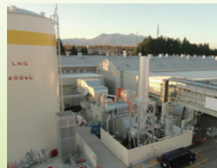
コ・ジェネレーションシステム
