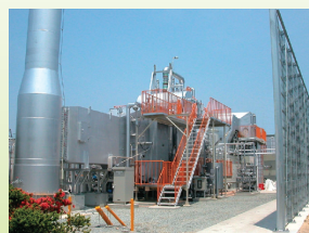
コ・ジェネレーションシステム
