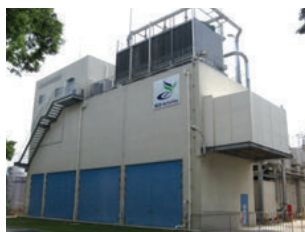
コ・ジェネレーションシステム
