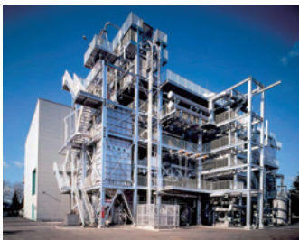
栃木工場焼却発電施設
