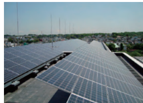
化工品試験・開発センターの太陽光発電パネル
