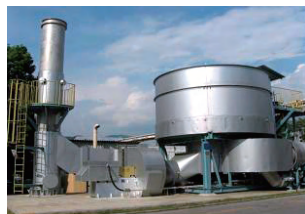
彦根工場における臭気対策装置 概観
